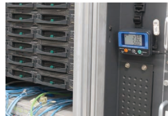
サーバールームの温湿度記録
