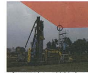
高圧電線との接触防止
